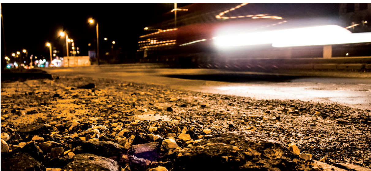
Wykruszona nawierzchnia, niebezpieczna dla szyb samochodu.
